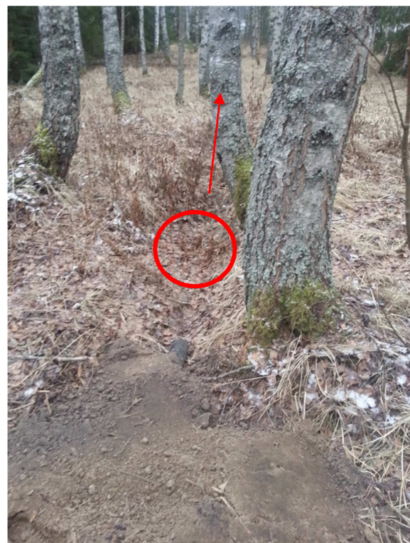
Kuva 4. Purku ojaan kokoomakaivon kautta. Purkuputken pää ympäröitynä ja virtaus nuolen osoittamaan suuntaan.
